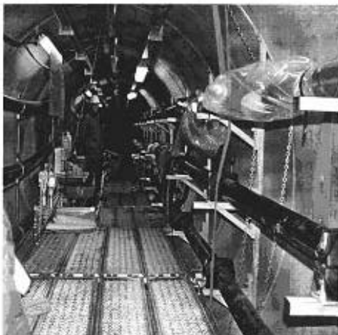
Photo: 380-kV groupe des jonctions dans le tunnel (sur chantier)
