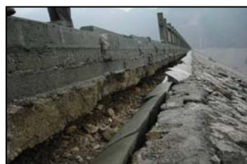
Le barrage de Zipingpu après le séisme du 12 mai 2008 - Source : Bernard Goguel
