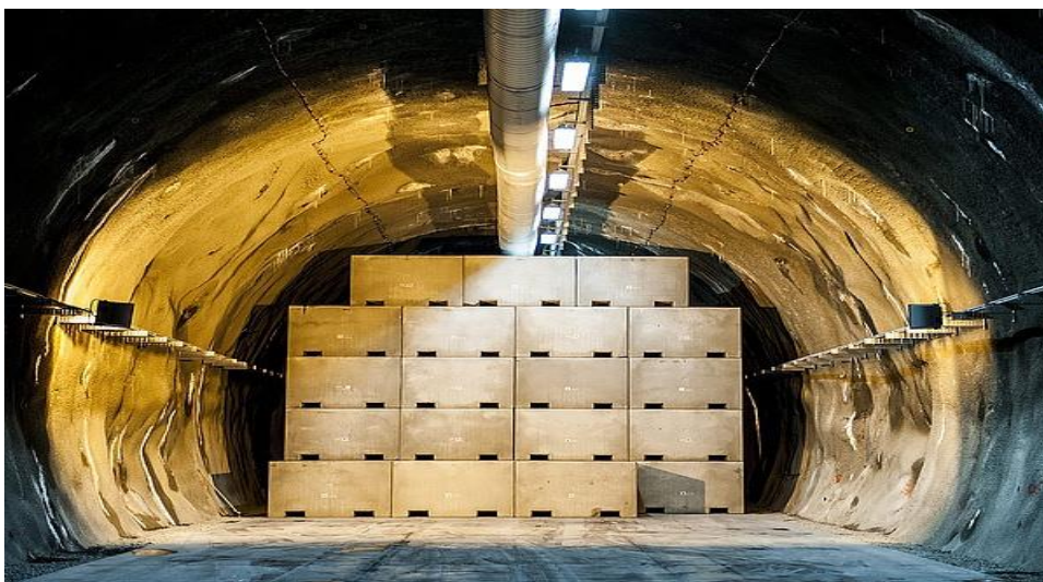
Alvéole du stockage souterrain NRHT à Bábaapáti (source : RHK Kft.).
