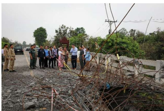
Pont ayant subi des dommages suite à un bombardement
